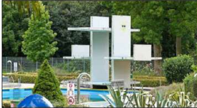
Das Waldschwimmbad in Breisach wird umfassend saniert. Insbesondere der Sprungturm – hier beim Abriss – muss erneuert werden. Foto: roc
